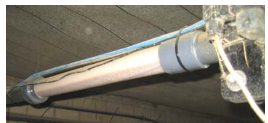
falsch positioniertes Futter in der Leitung
